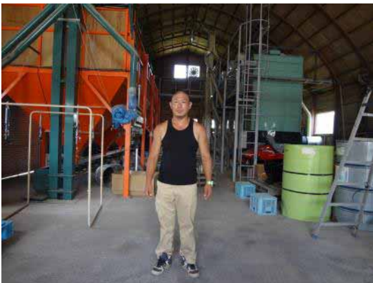
新しく設置した乾燥施設
