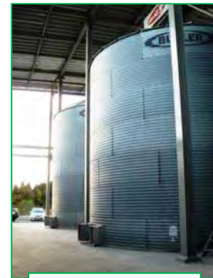
大きな貯留タンク
